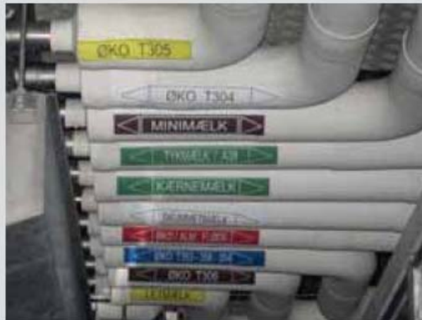
Ofte kan forkert eller mangelfuld mærkning af rør, knapper, glas og lignende medvirke til, at der opstår fejl. Her er rørene mærkede, men rørene på Arla i Hobro kunne godt have haft forskellige farver. Måske var ensfarvet maling billigere?
